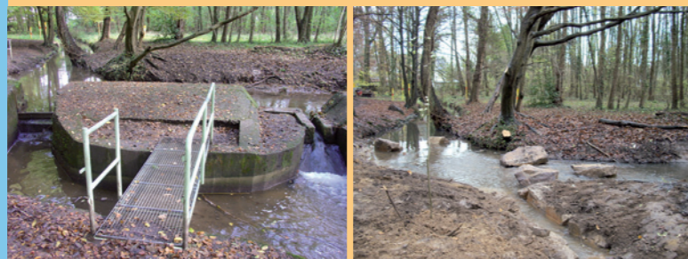
Beseitigung des Verzweigungsbauwerks am Grundloch an der Strunde, vor (links) und nach der Baumaßnahme (rechts)
